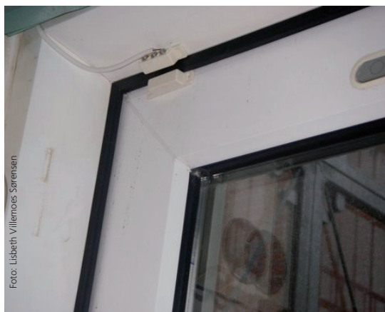
Monterad sensor till dörrlarmet.
